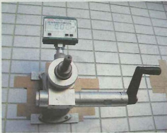
外壁タイルの引っ張り検査。専用の機器を使い、強度を調べる
