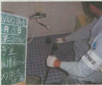
排水管の中の状態を、テレビカメラを管の中に入れてチェックする
